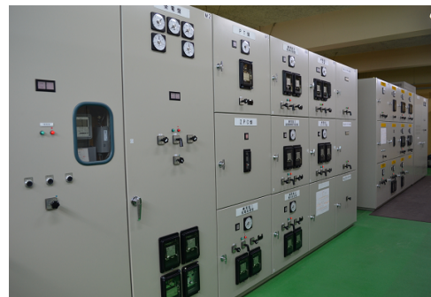
【写 2】 構内受電設備（三段積 Cub）
